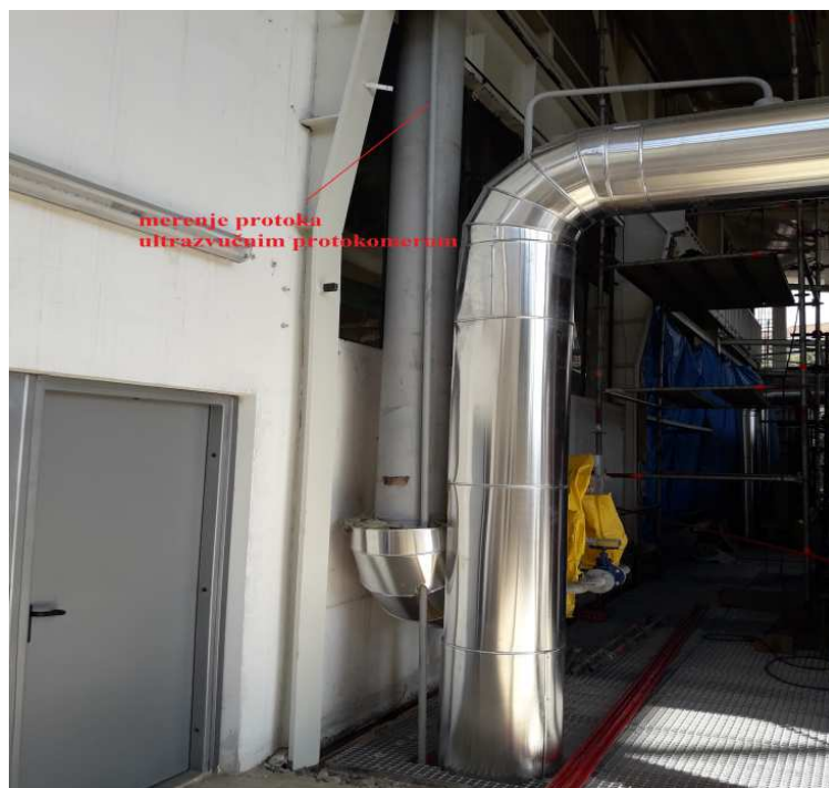
Slika A 2.6 Merno mesto za merenje protoka radnog fluida na izlazu iz bilansne granice (nema potrebe za bilo kakvim radovima osim skidanja dela izolacije i postavljanja skele za rad)
